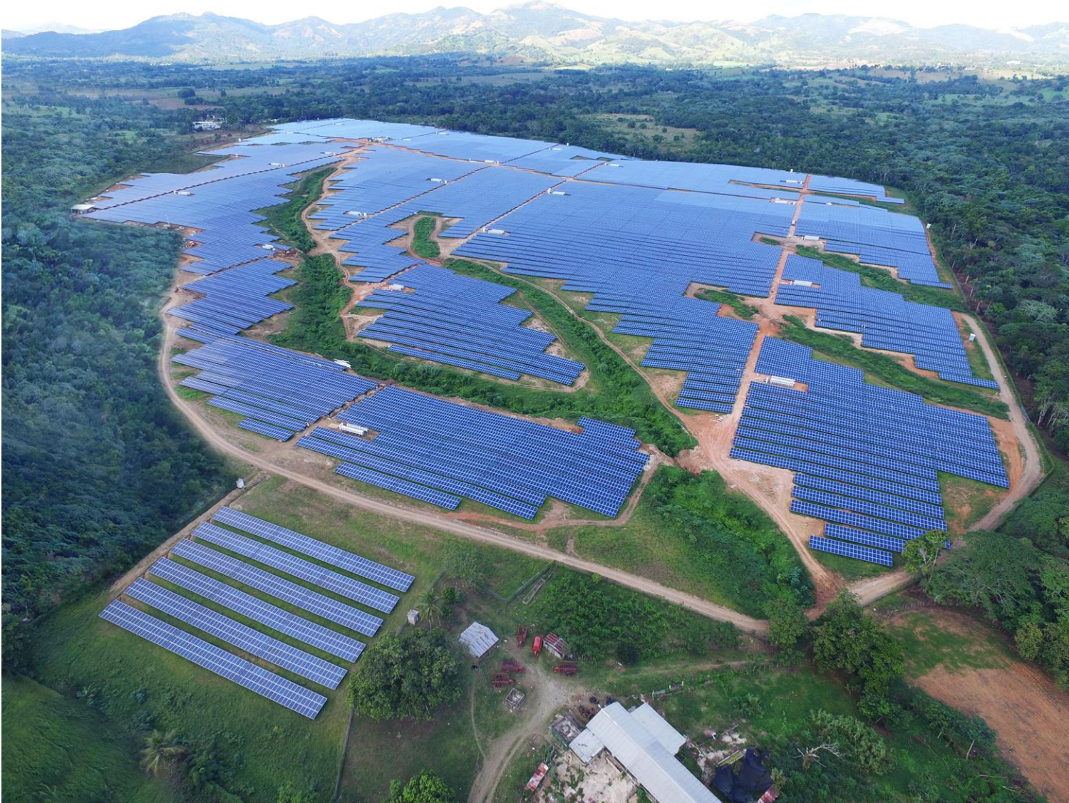
照片 2 永旺能源多明尼加共和國 Monte Plata 第一期 34MW 空拍照片
